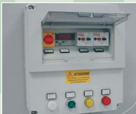
Quadro elettrico di comando
